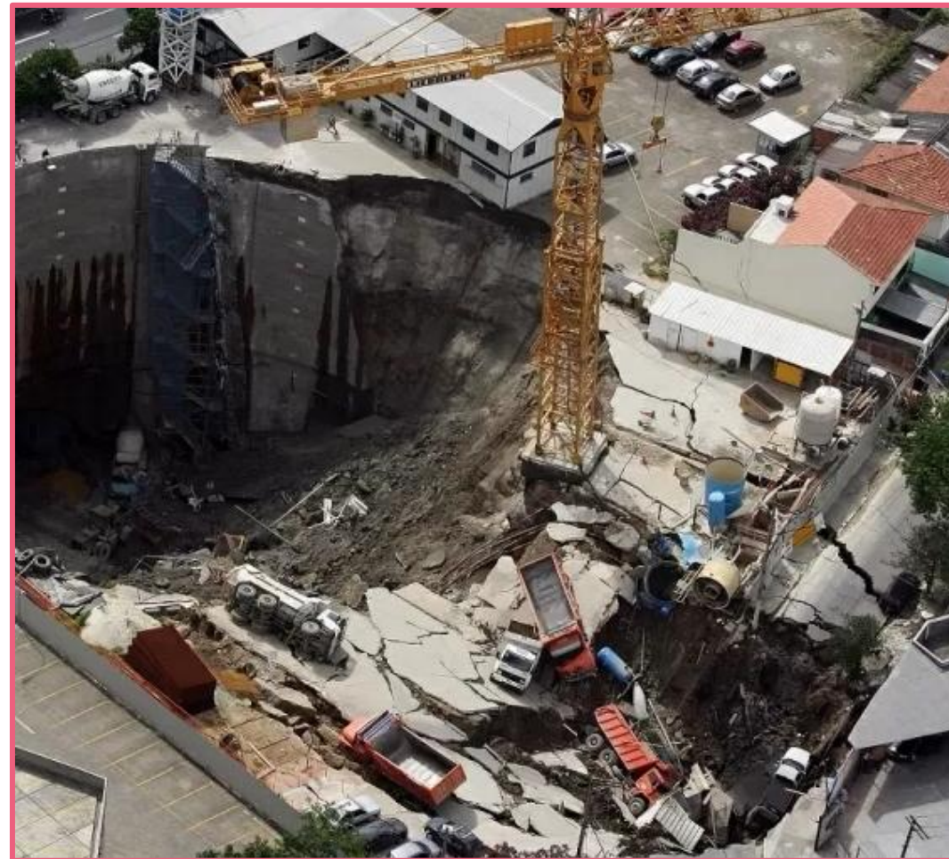
Cratera de 80 metros na região da estação Pinheiros – SP.
